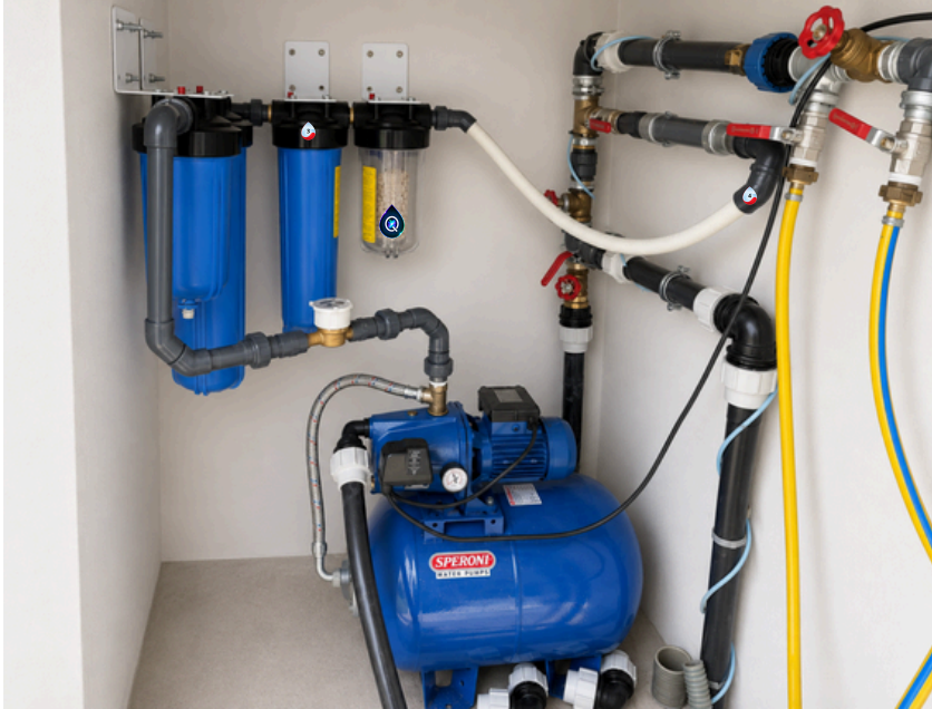
installation de purification après une phytoépuration Domaine de Marie (84) BIOMETIC
