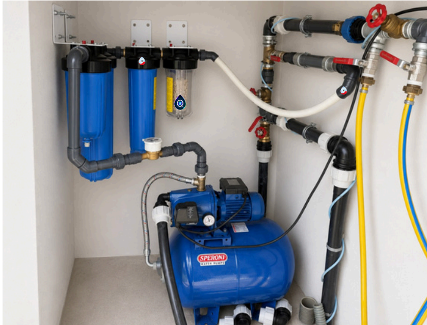
Installation de purification après une phytoépuration Domaine de Marie (VAUCLUSE) BIOMETIC France Nous réalisons vos installations sur mesure selon vos critères, le type d'eau et les pollutions présentes
